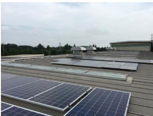
写真 2.2.4 PV モジュール (2)
