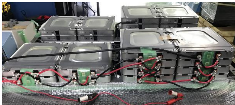
写真 3.2.2 パート No.3 並列接続にて充電している様子
