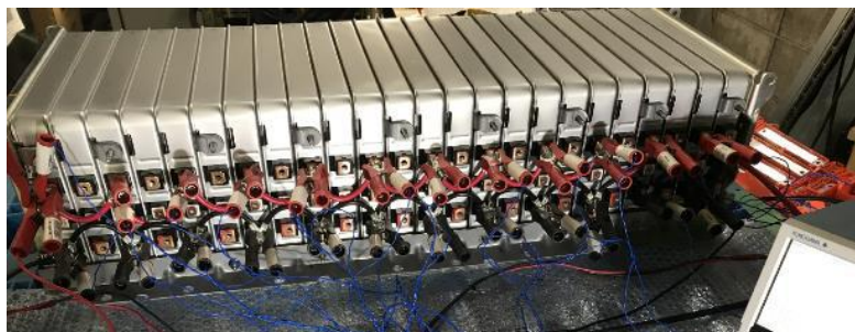
写真 3.2.1 パート No.1. 並列接続にて充電している様子
