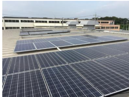
写真 2.2.3 PV モジュール (1)
